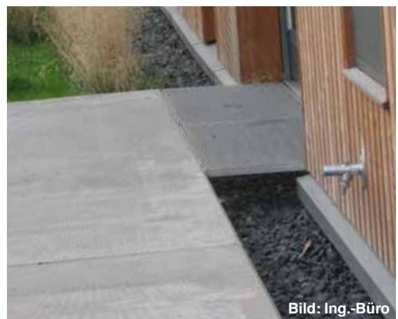
Abb. 63 Rampenartige Ausbildung von Podesten. Überquerung zur Eingangstür mit Gitterrosten.
