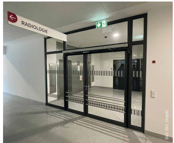
2-flügelige Fluchttür mit Panikfunktion, Zugangskontrolle und Schließfolgeregelung
